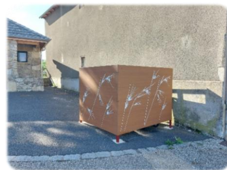
Pose d'habillage autour des containers d'ordures ménagères à côté des WC publics.
